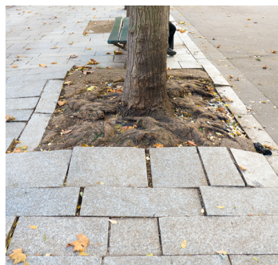
Photo 3 - Dalles de granit soulevé et racines d'arbre en surface.
