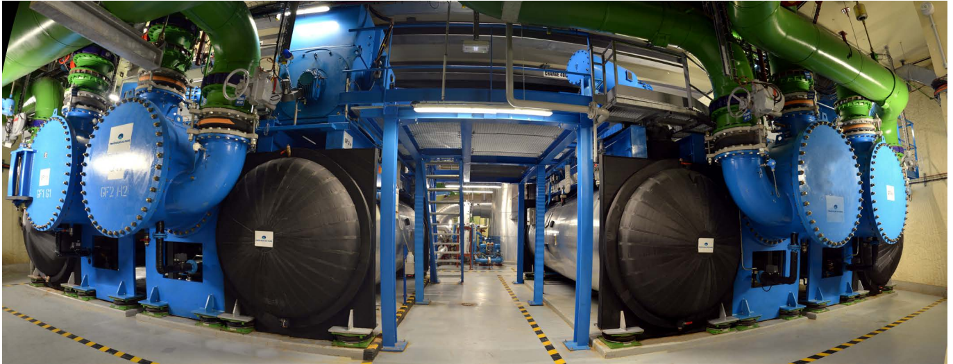
L'intérieur de la centrale "Canada" du réseau de froid de la Ville de Paris. (Crédits Fraîcheur de Paris)
