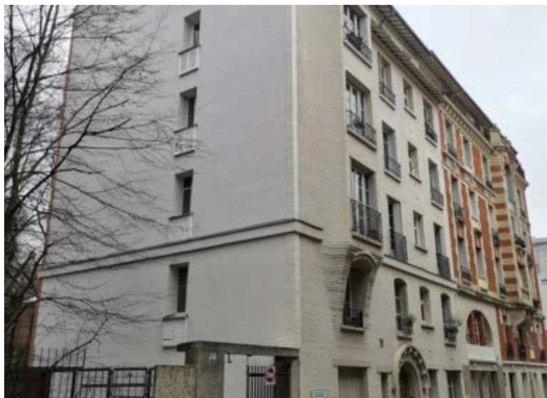
Un bâtiment du 20 e siècle rénové de l'extérieur avec de l'isolant biosourcé rue de la Réunion, dans le 20 e arrondissement
