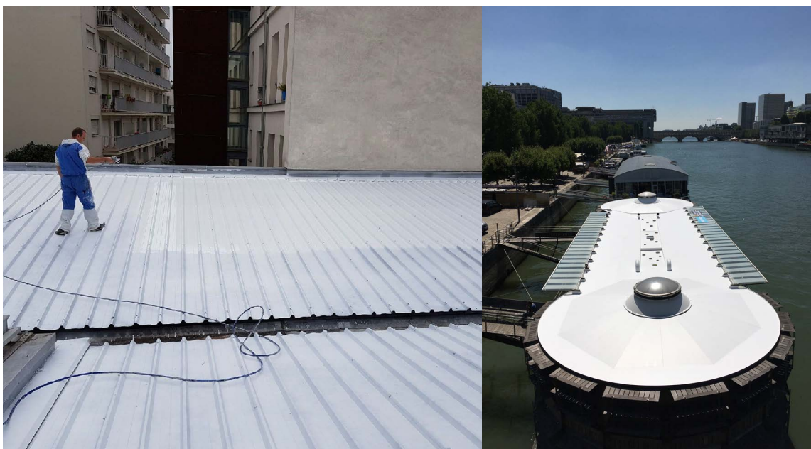
Application d'une peinture anti-chaaleur sur le gymnase Berlemont, 11 e arrdt. ; la péniche-hôpital Adamant, 13 e arrdt. (Crédits CoolRoof)
