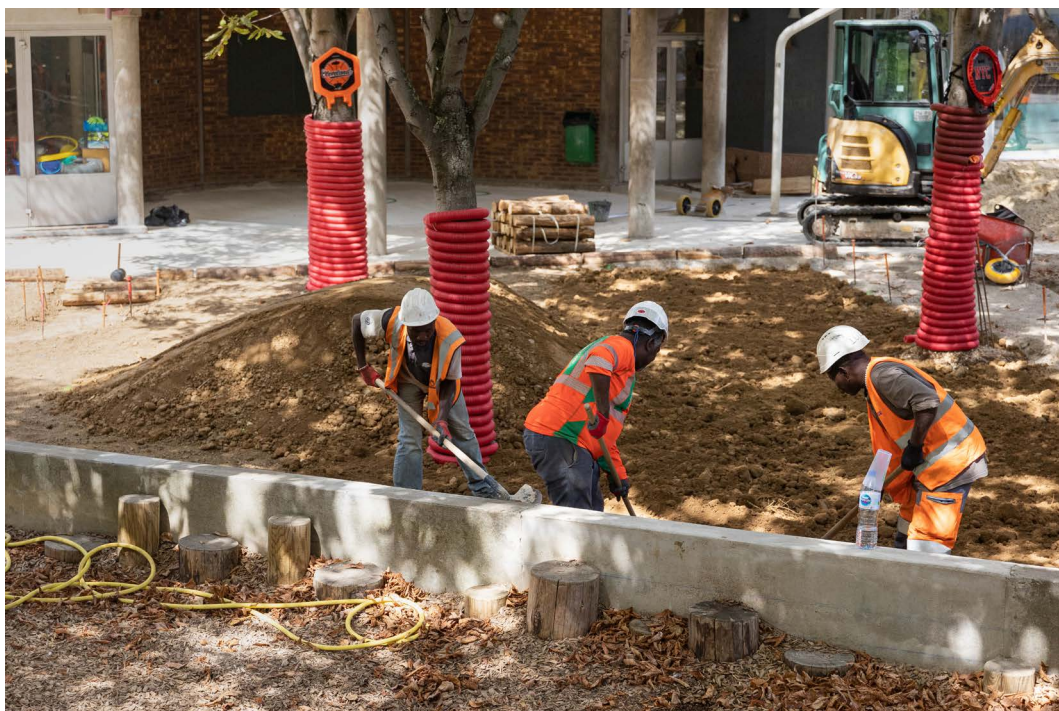
Travaux de terrassement en juillet 2022 dans la cour de l'école élémentaire Emeriau (15 e ) (crédits Guillaume BONTEMPS / Ville de Paris)
